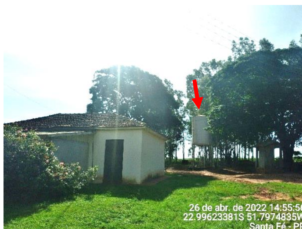
Figura 156 – Armazenamento de água de captação de poço em uma propriedade da área de estudo.
